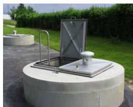
Controllo livello pozzo
