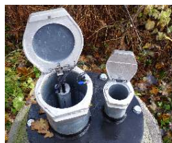
Stazione di misura della falda
